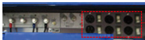
発電機側コンセント ×6個
