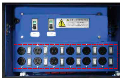
発電機側コンセント ×12個
