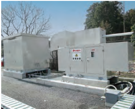
通信施設(油庫付)
