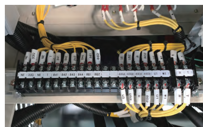
接続端子台 (盤内)
