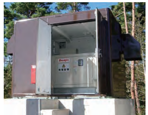
防災無線設備
