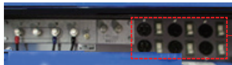
発電機側コンセント ×6個
