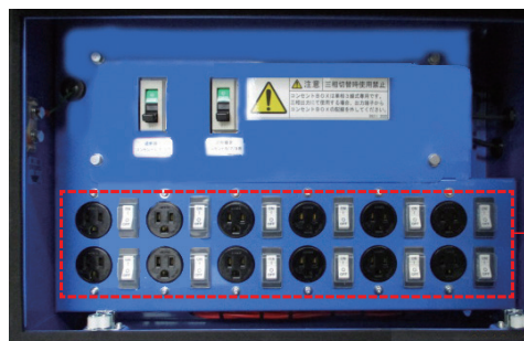
発電機側コンセント ×12個
