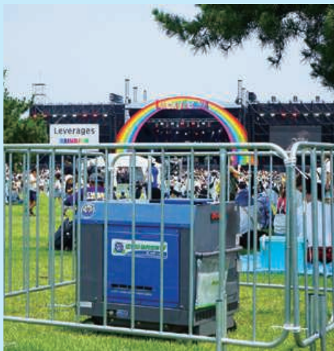
会場で電力を供給する発電機
