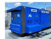
水素混焼発電機
