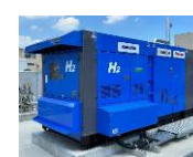
水素混焼発電機
