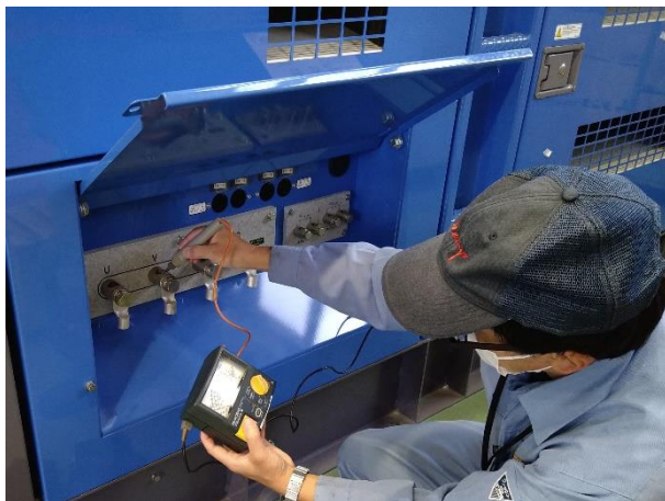
発電機の絶縁測定
