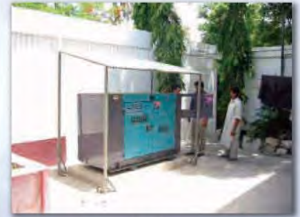
Como fuente de alimentación de emergencia en el hospital.
