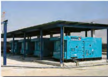
Como fuente de alimentación en el área en donde no hay electricidad disponible.
