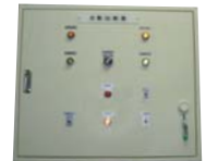
電源切替盤(ATS盤)※2
